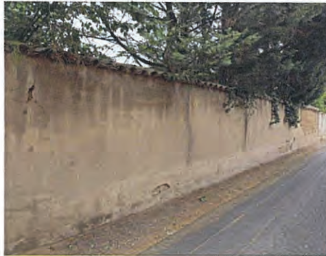
exemple de mur maçonné enduit et protégé par une couvertine en tuiles creuses
