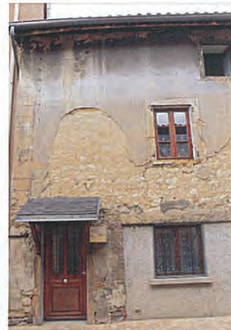
exemple de façade déstructurée
