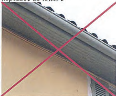
les dépassées de toitures lambrisées sont prosrites...
