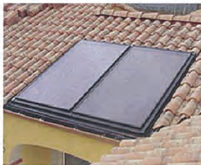
exemple de panneaux solaires thermiques
